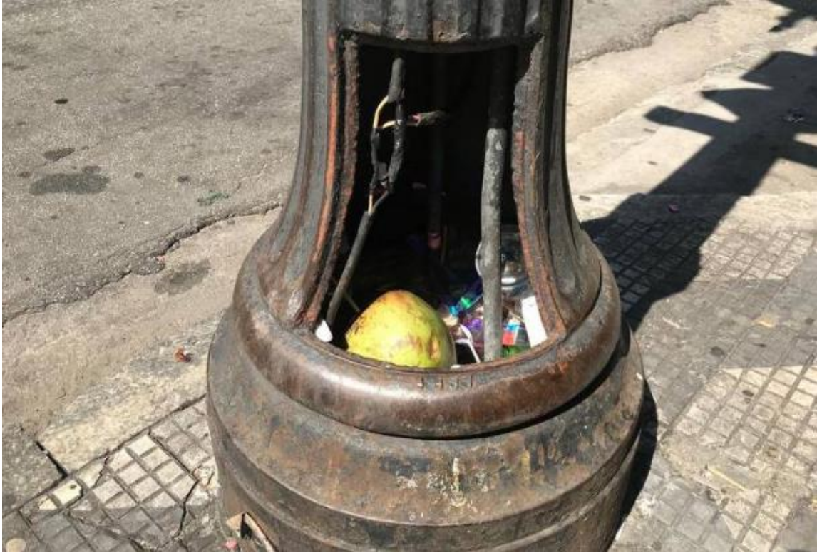
Figura 09: tampa de ferro fundido furtada devido a ausência de solda.
