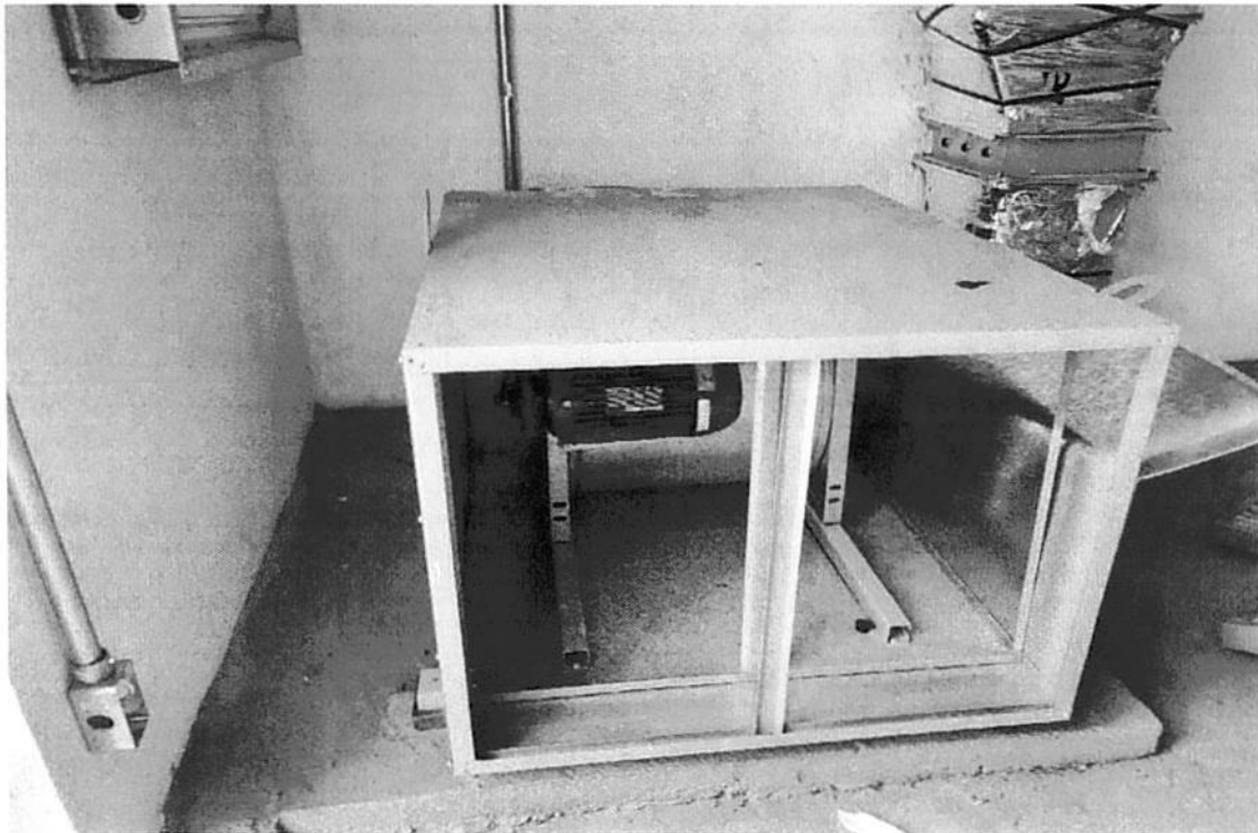
Motores do aparelho de ar condicionado central foram danificados
