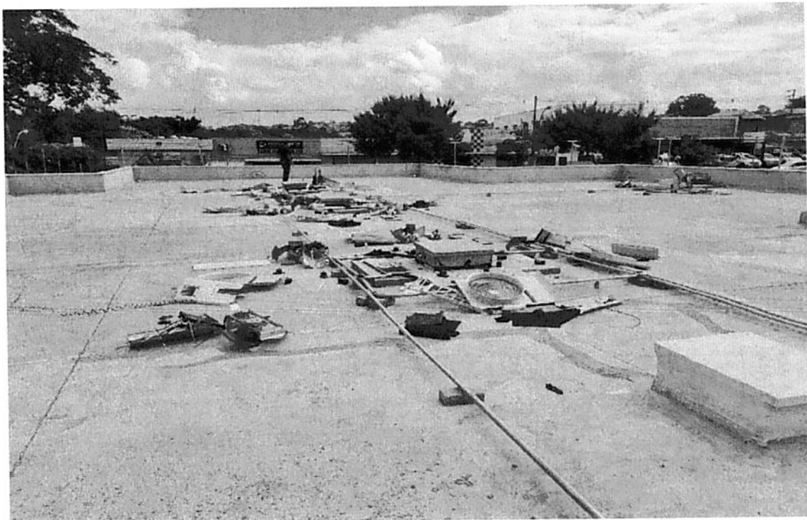
Aparelhos condensadores destruídos para furto das partes internas com cobre
