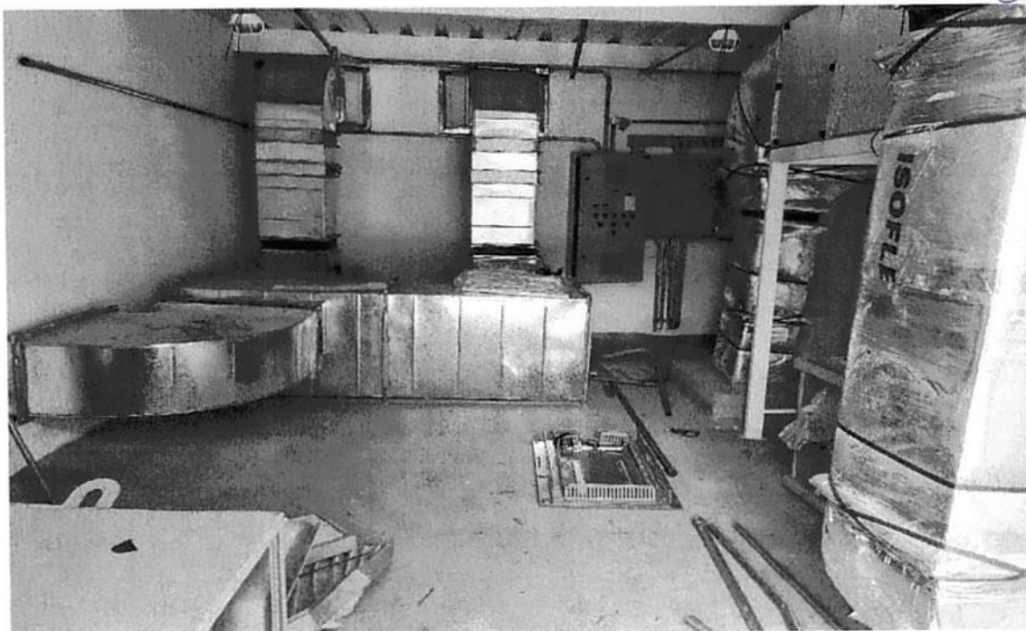
Central de casa de máquinas - furto de todos os cabos de distribuição
