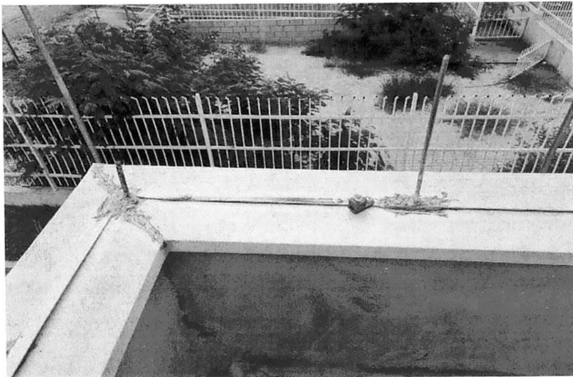
Foram furtados os cabos de decida de aterramento dos para-raios
