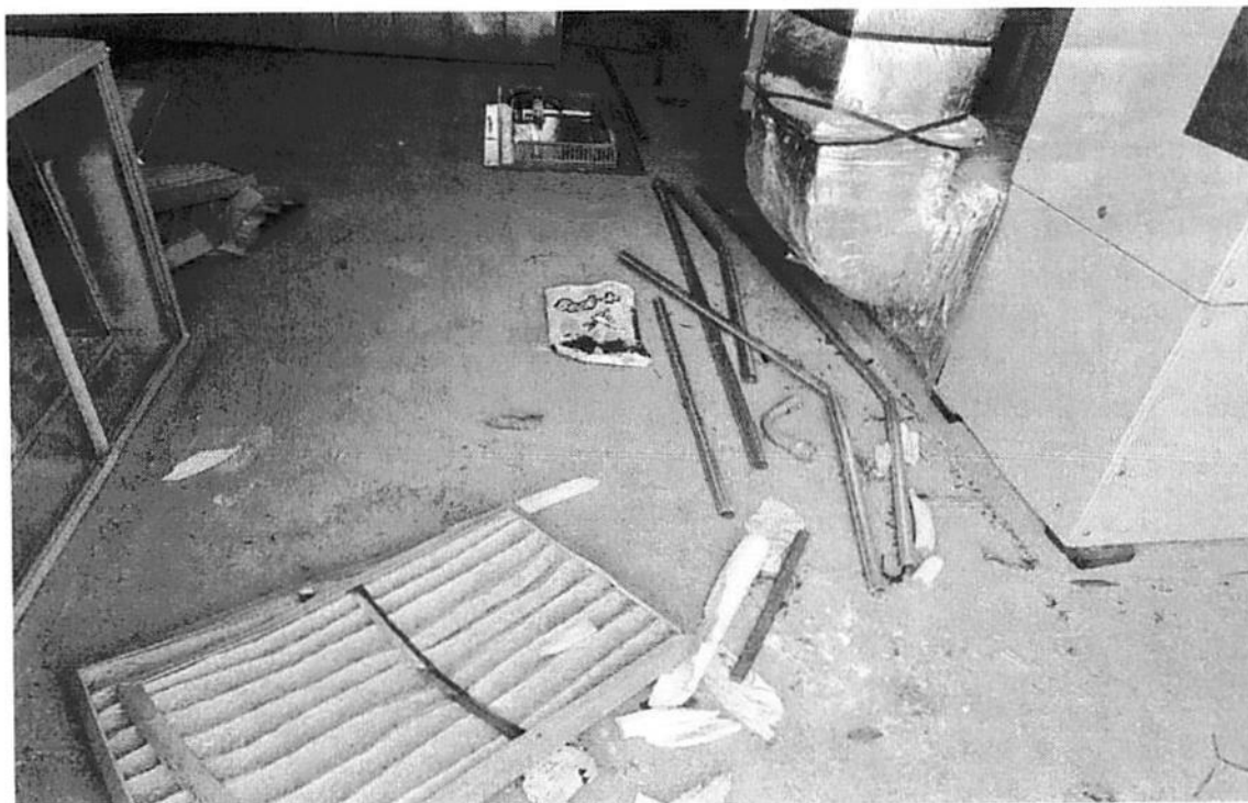
Parte dos equipamentos da casa de máquinas foram danificados
