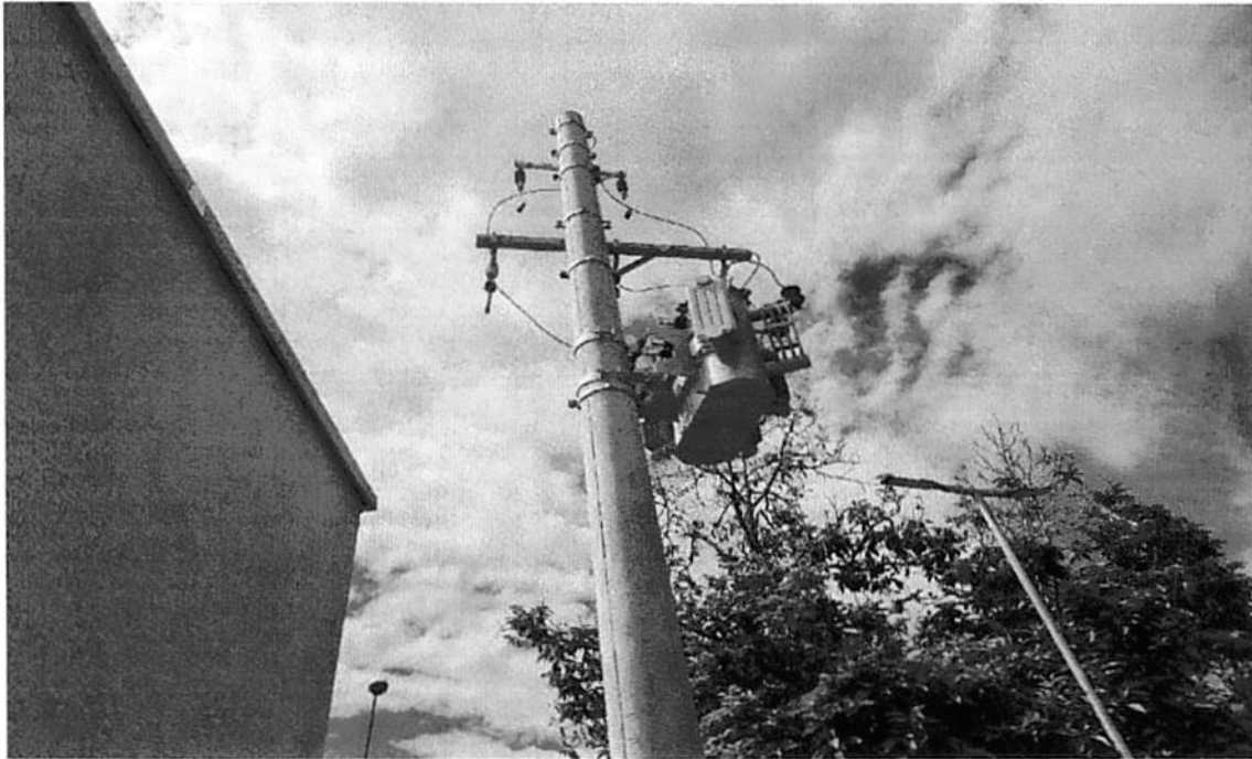
Entrada de energia ainda não foi ligada pela concessionária
