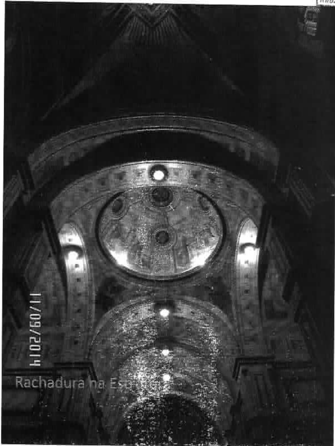
Figura 20 – Rachadura na estrutura 09.
