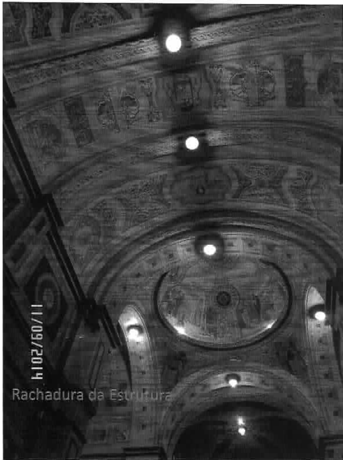
Figura 22 – Rachadura na estrutura 11.
