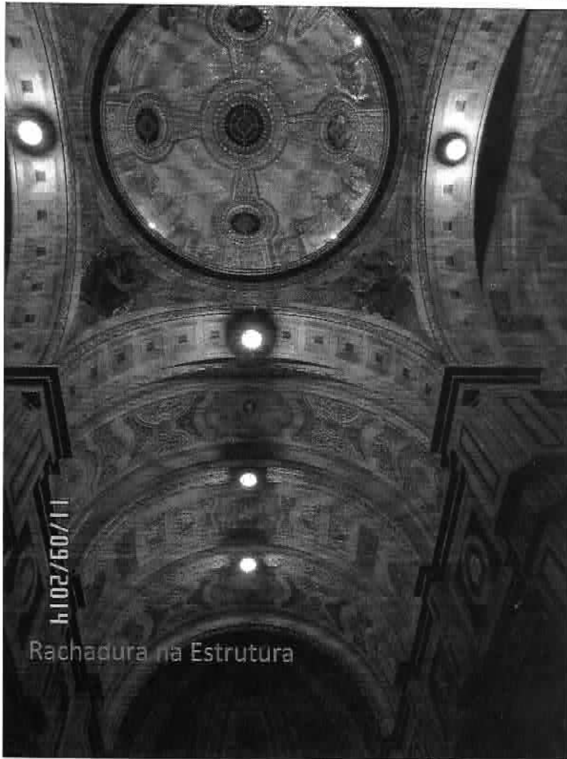
Figura 21 – Rachadura na estrutura 10.
