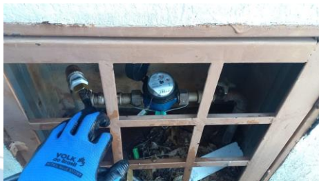
Foto 2 – Abastecimento no Imóvel
